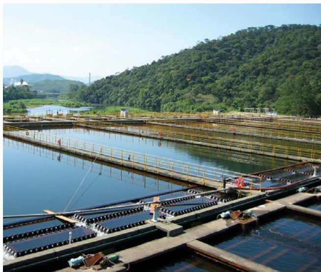
Figura 10 – Tratamento de água (ETA Cubatão) para abastecimento de municípios da Baixada Santista, SP – Foto Consoni/IPT
